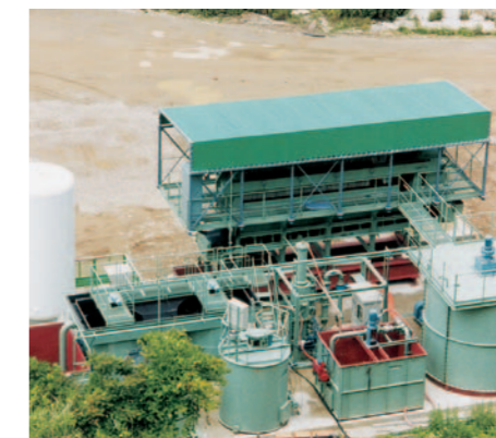
濁水処理設備
