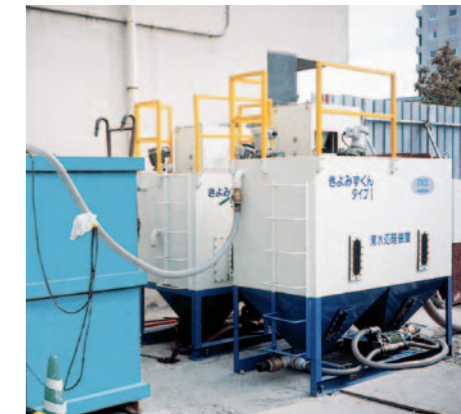
濁水処理装置
